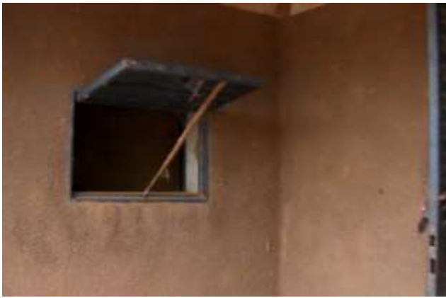
L'ouverture donnant sur l'entrée et permettant de passer les téléphones
